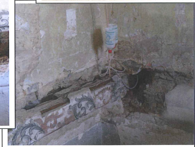
Předměstský dům čp. 62, Lochotínská 24, Plzeň, Celkový pohled z ulice, poškozený okenní portál a nálezové detaily torza malovaného stropu nad přízemím vč.prováděného zajištění, nemovitá kulturní památka, rejstř.č. ÚSKP 101531.
