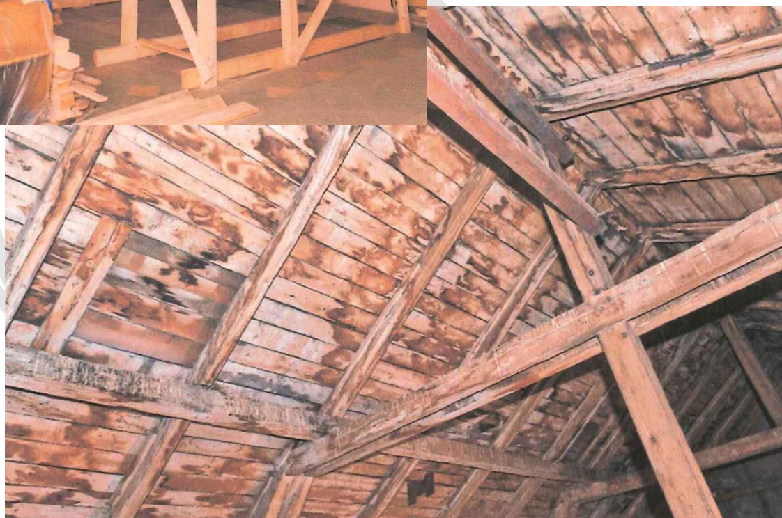
Kostel sboru Karla Farského, Husova 1, Plzeň, nahore – strop kostelní lodi zajištěný podepřením, dole – pohled na stav kostelního krovu, nemovitá kulturní památka rejst. č. ÚSKP 51222/4-5259.
