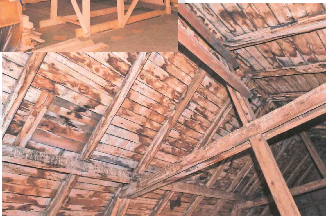
Kostel sboru Karla Farského, Husova 1, Plzeň, nahore – strop kostelní lodi zajištěný podepřením, dole – pohled na stav kostelního krovu, nemovitá kulturní památka rejst. č. ÚSKP 51222/4-5259.
