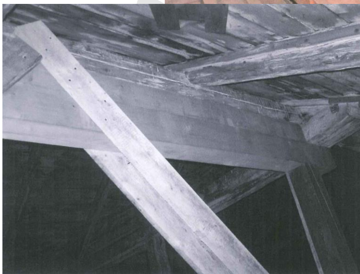
Kostel sboru Karla Farského, Husova 1, Plzeň, Uliční průčelí kostela, vpravo – snímek stavu nosné stropní konstrukce, dole – podepření krovu, nemovitá kulturní památka rejst. č. ÚSKP 51222/4-5259.
