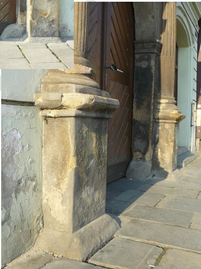
Měšťanský dům čp. 135, náměstí Republiky 21, Plzeň celkový pohled na domovní portál a detail stavu materiálu – patní část nemovitá kulturní památka rejst. č. 22811/4-166 ÚSKP.
