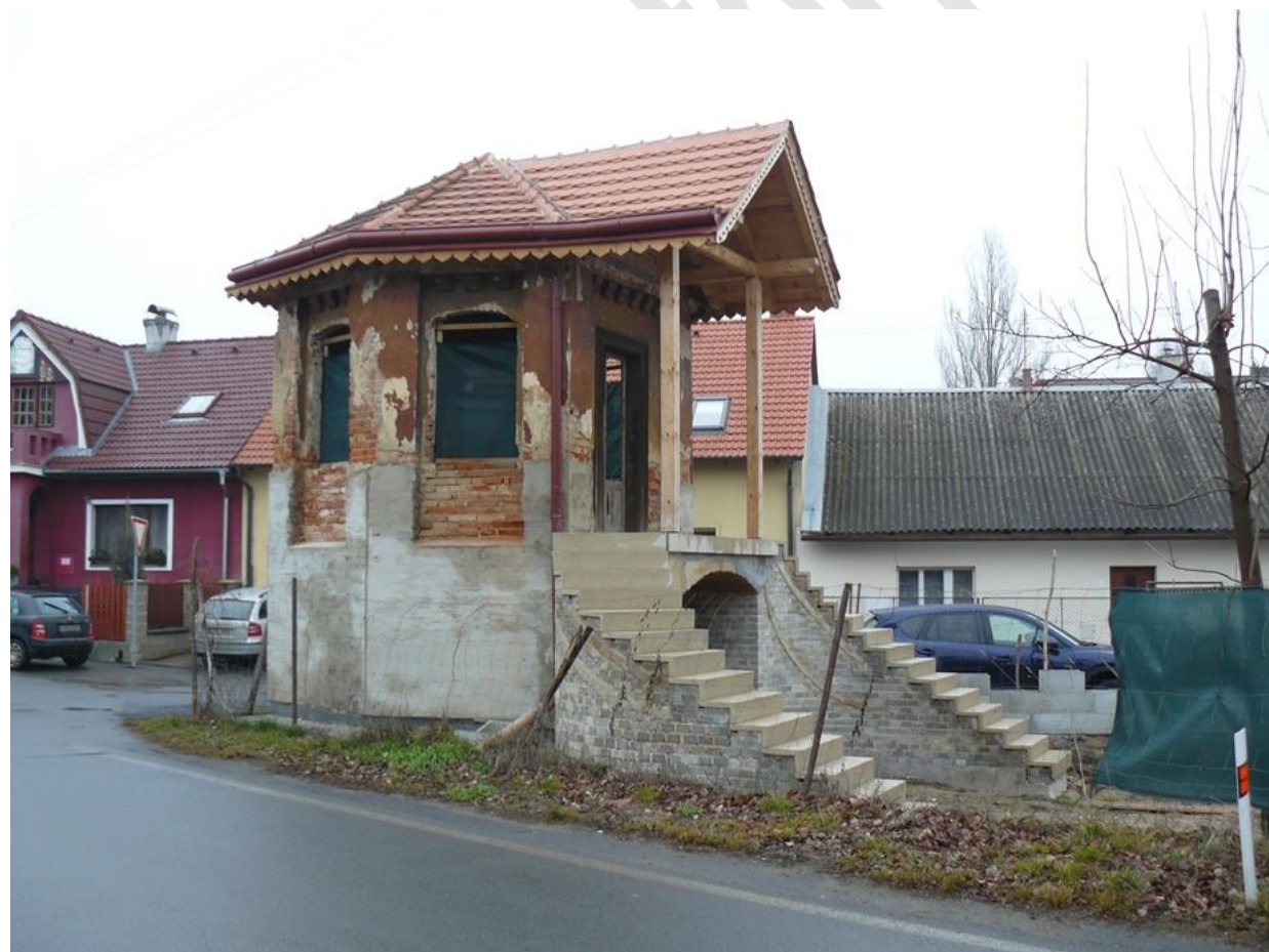
Zahradní altán v areálu Kleisslovy vily čp. 260, Lochotínská 60, Plzeň, čelní a boční pohled po dokončené etapě obnovy v roce 2013, nemovitá kulturní památka rejst. č. 37418/4-4454 ÚSKP.
