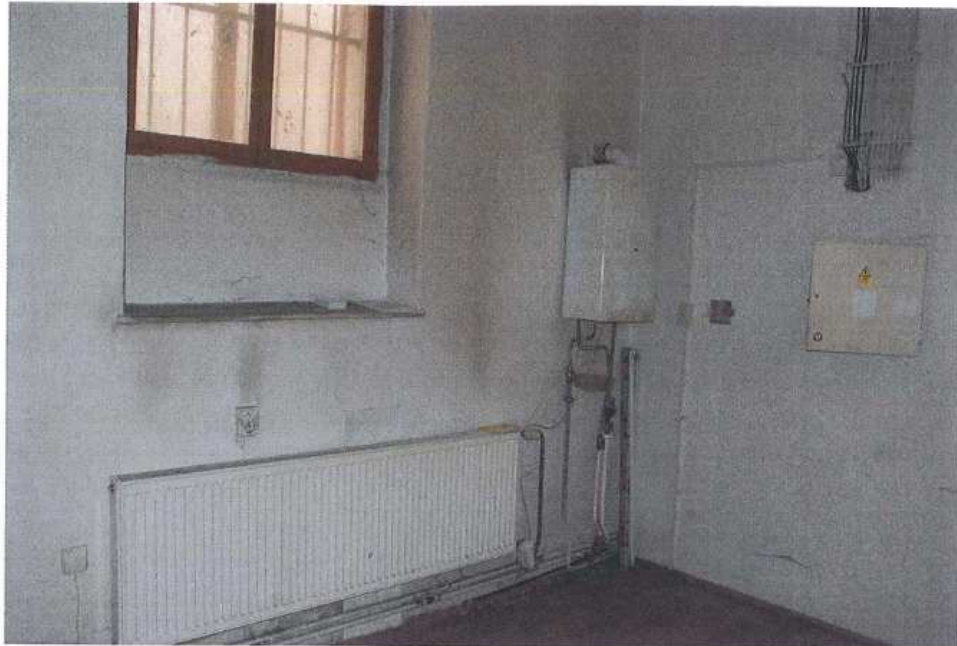
Pohled do prostřední místnosti s kotlem ÚT
