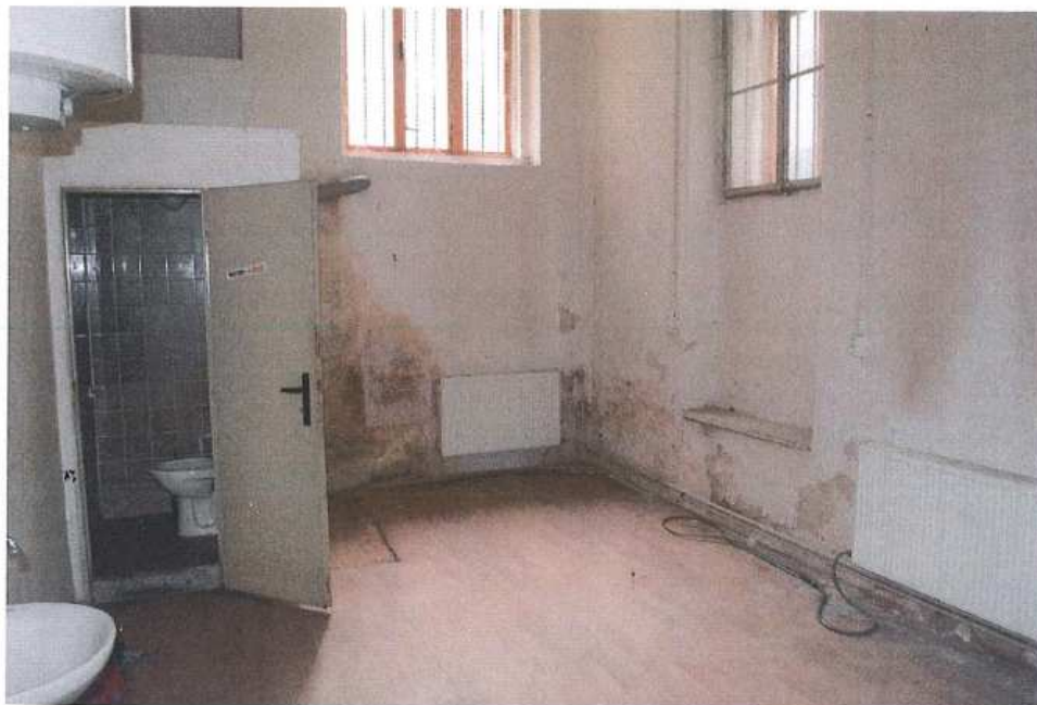
Pohled do zadní místnosti s WC, umyvadlem a elektrickým bojlerem (viditelné poškození omítek)
