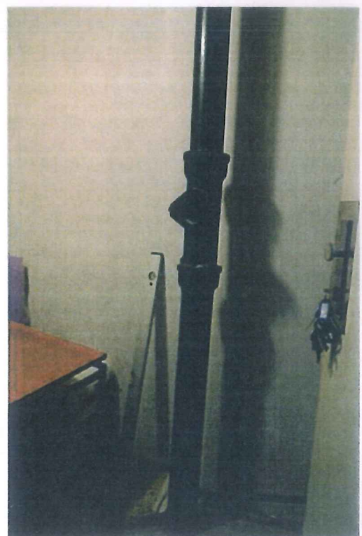
Svislý rozvod kanalizace s čistícím kusem
