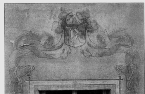
▷ Náleзовý stav - celkový pohled, poškození barevnosti postupným vymytím
