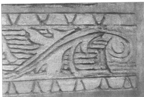
▷ Náleзовý stav - postup rozvození (eroze) sgrafita (intonaco bianco)
