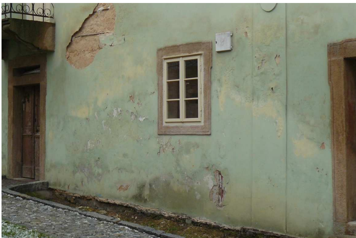
Venkovská usedlost čp. 2, Rolnické náměstí 4, Plzeň – Lobzy, obytné stavení – zahradní a detail dvorního průčelí – fasády namáhané vlhkostí nemovitá kulturní památka rejst. č. 50798/4-5226 ÚSKP.
