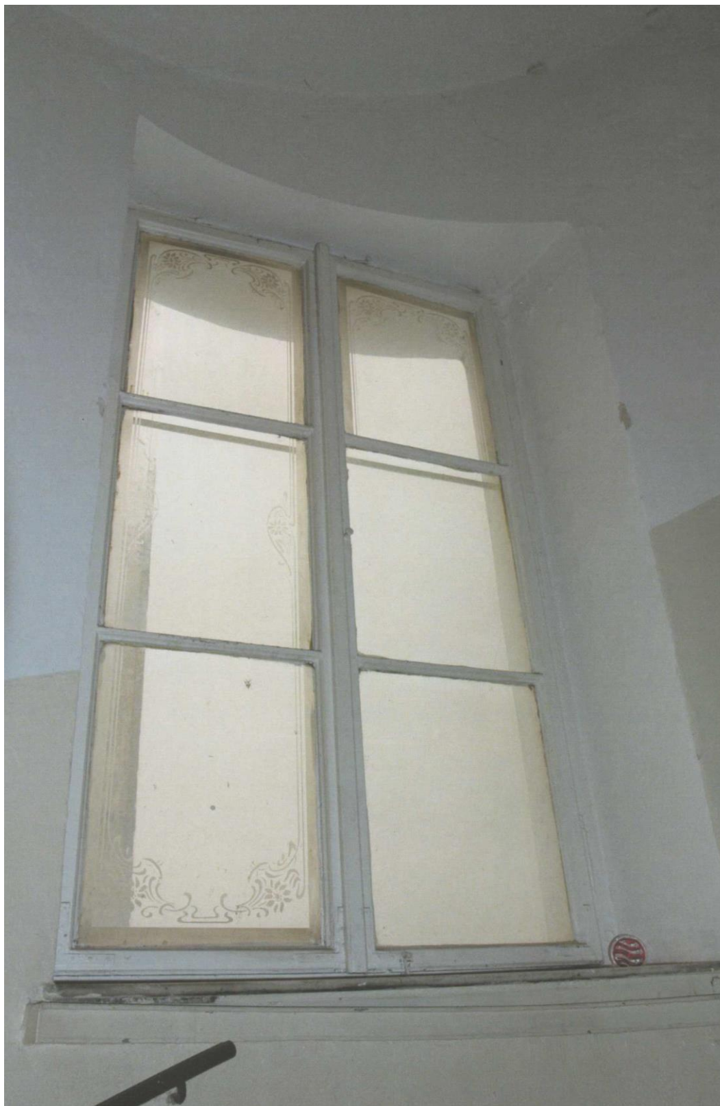
Činžovní dům čp. 178, Bezručova 20, Plzeň, původní schodišťové okno, nemovitá kulturní památka rejst. č. ÚSKP 44269/4-4712
