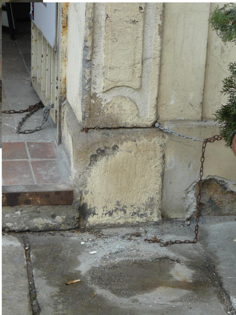
Měšťanský dům čp. 170, Prešovská 5, Plzeň, pohled na barokní portál – detail poškození, nemovitá kulturní památka rejst. č. ÚSKP 14051/4 – 4407.
